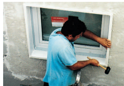
A horonyba való beütéssel (például gumikalapáccsal) kell rögzíteni a szigetelést a szigetelécscsatlakozó-profil és a homlokzat között. A rögzítéshez a kereskedelemben kapható homlokzati ragasztó alkalmas. A kereskedelemben kapható vakolóprofilokat is be lehet állítani.
